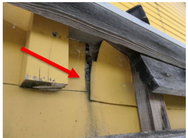
Décollement de la membrane de Stamisol au droit des écoulement latéraux des tablettes
