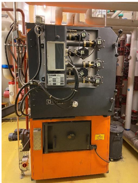
Production de chaleur bois
