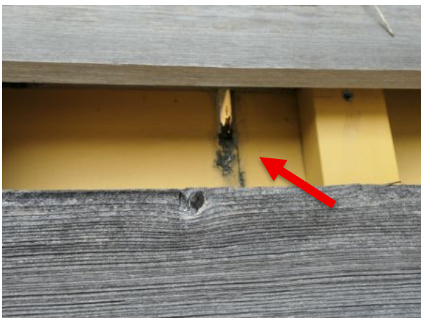
Obstruction des écoulements latéraux (extérieur)
