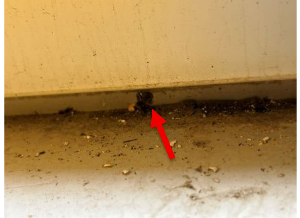
Obstruction des dégorgeoirs des tablettes (intérieur)
