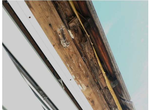
Dégradation de la structure en bois de l'embrasure de la fenêtre.
