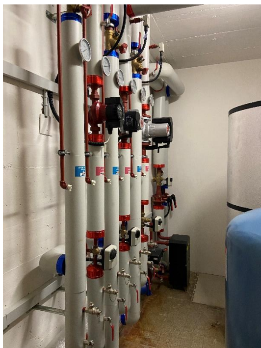
Sous-station de chauffage du collège
