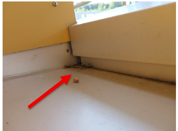
Obstruction des écoulements latéraux (intérieur)
