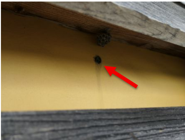
Obstruction des dégorgeoirs des tablettes (extérieur)
