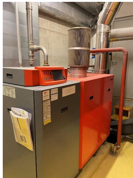
Production de chaleur gaz
